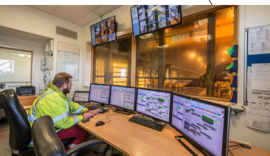
(1) SISTEMA DI CONTROLLO AUTOMATICO 24/7
